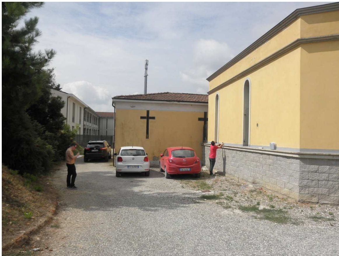
Foto n. 3 – Ingresso secondario del Cimitero: area di intervento (foto precedente ai lavori propedeutici di escavazione e rinterro)
